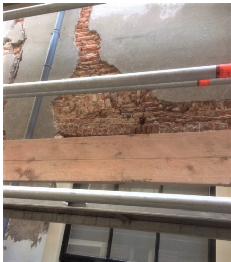
Vanonder de oude stuc laag komt een heel slechte muur te voorschijn.
